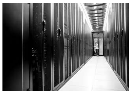
工作人员在贵州贵安新区数据中心机房内巡检。
