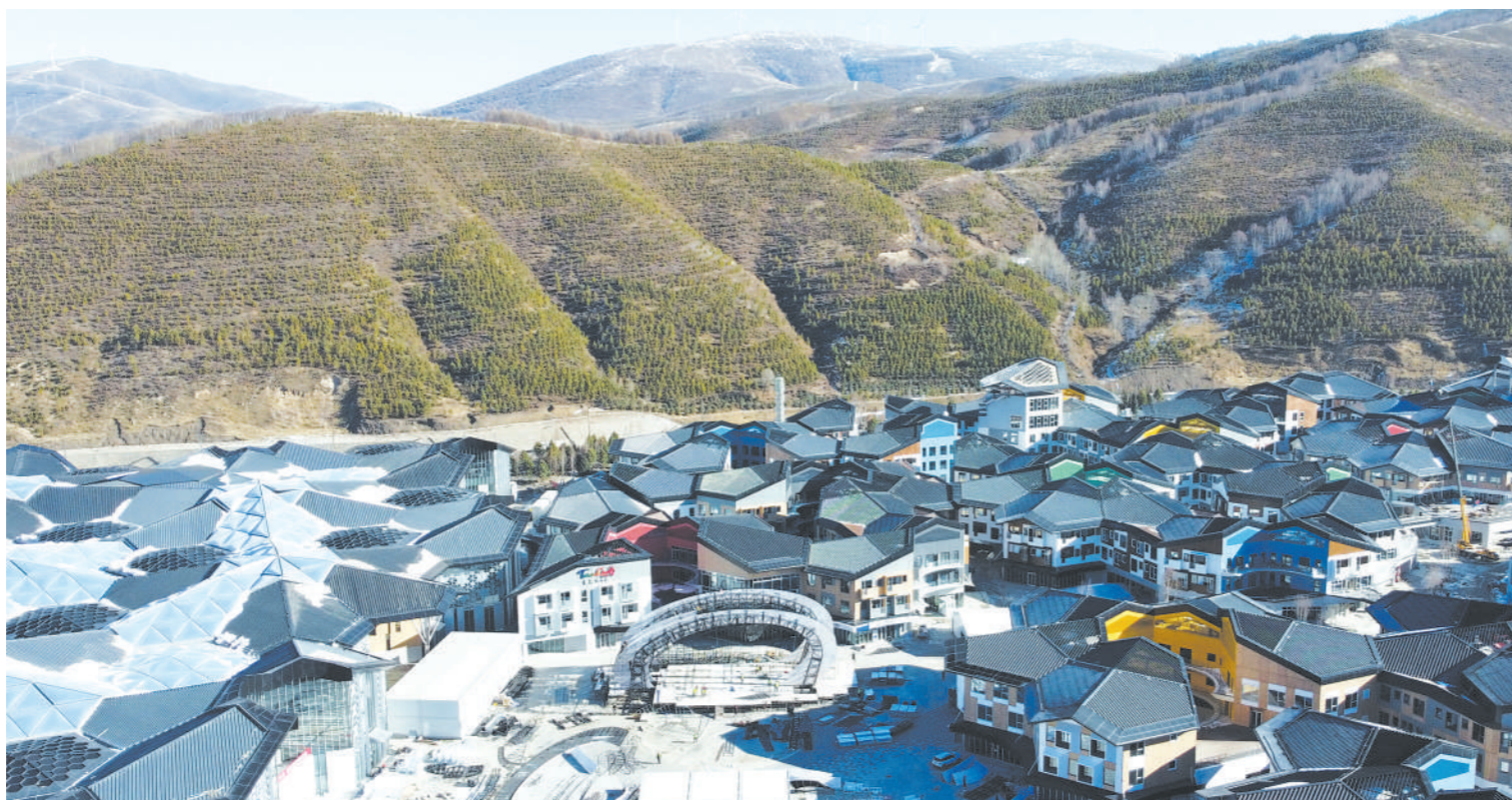
近日，2022年北京冬奥会张家口赛区颁奖广场建设加速。据介绍，颁奖广场位于崇礼太子城冰雪小镇内，方案主题为“激情逐梦”，以张家口赛区雪上项目为出发点，用极具动感的线条勾勒舞美形态，辅之雪山造型点缀，充分契合张家口赛区场地自然条件和雪上项目。图为11月27日拍摄的位于张家口赛区崇礼太子城冰雪小镇内的颁奖广场舞台。新华社发
