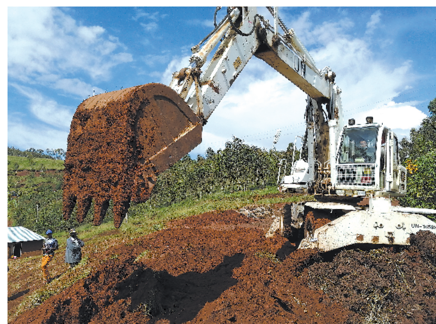
近日,中国第24批赴刚果(金)维和工兵分队顺利完成刚果(金)南基伍省瓦伦古地区的联合国通信基站进出道路修缮任务,受到联合国维和工程部门的高度评价。图为我维和官兵在进行施工。 席海春摄
