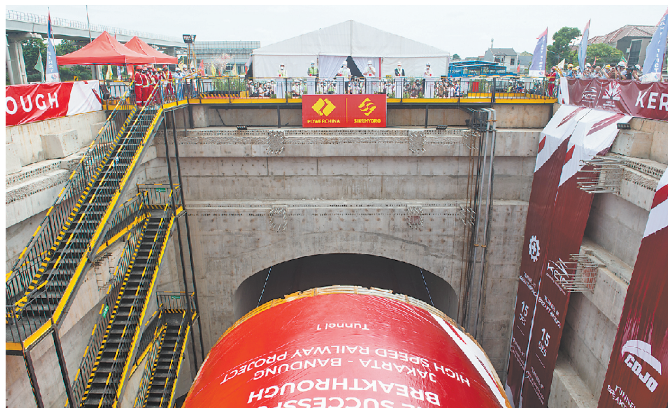
12月15日,印尼雅万高铁1号隧道顺利贯通。隧道位于印尼首都雅加达市内,由中国铁集团所属中国铁路国际公司牵头的中方施工联合体负责施工。雅万高铁是“一带一路”建设和中印尼两国务实合作的标志性项目,也是我国高铁首次全系统、全要素、全产业链在海外落地的典范工程。图为贯通后的雅万高铁1号隧道。新华社发
