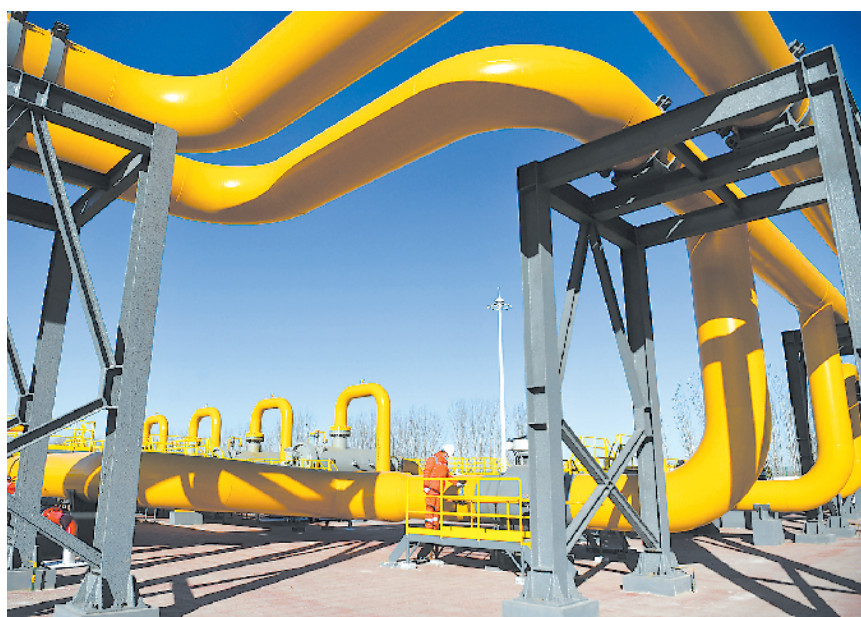
12月3日,中俄东线天然气管道中段(吉林长岭-河北永清)正式投产运营,意味着京津冀地区可以直接使用俄罗斯的天然气。图为工作人员在中俄东线天然气管道中段永清压气站工作。
