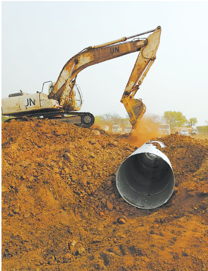
当地时间4月2日,中国第10批赴苏丹维和工兵分队官兵克服高温天气带来的不利影响,仅用两天时间就高质量完成了马坡儿至瓦马路段一处排水管线的铺设任务,确保当地道路畅通。图为施工现场。 许向民摄
