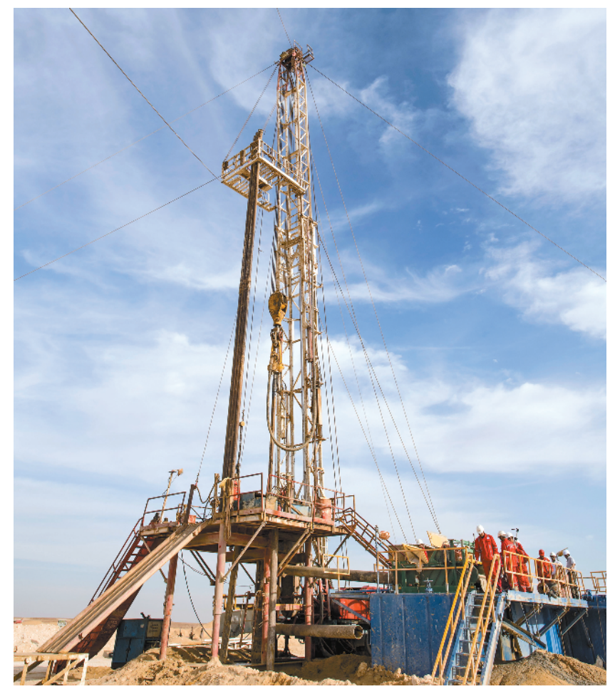
这是11月20日在埃及明亚省的沙漠中拍摄的钻井现场。2017年,中国中石油公司与阿联酋海湾集团签订合同,为该集团在埃及沙漠中的大型农业项目钻探300口水井。目前有超过200名工人在钻井现场作业,大部分是埃及本地人。新华社发
