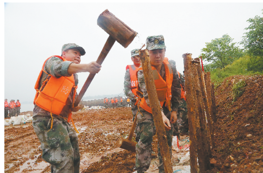
连日来,江西省吉安军分区在汛期来临之际,组织民兵在赣江水域某段打桩加固堤坝,确保安全渡汛。
